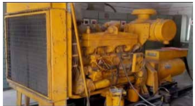
200KVA DG Set at ESS-5
