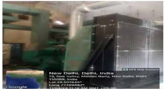
500KVA DG set at ESS-2
